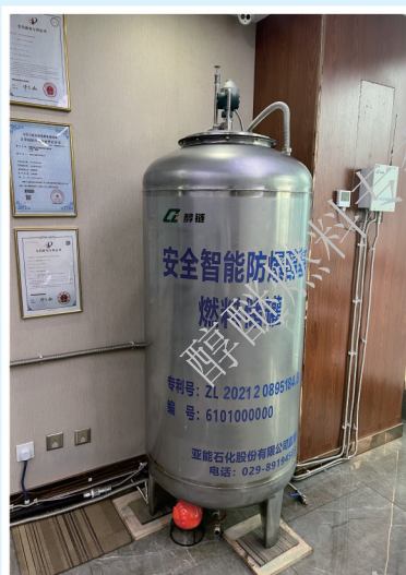
图18 安全智能防爆醇基燃料储罐
